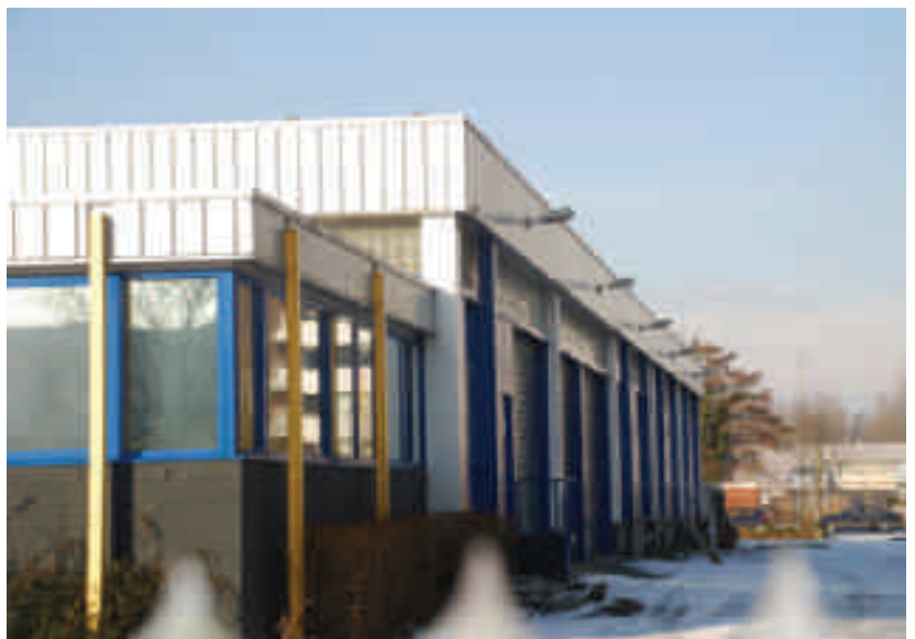
Is hier sprake van voldoende hemelwaterafvoer en waar is de noodoverlaat?
